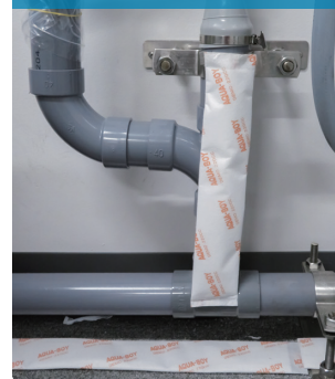
ビル内の給排水設備
