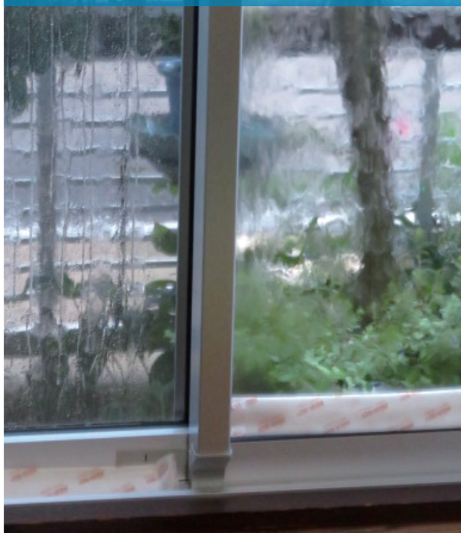
結露や台風時の吹込み水
